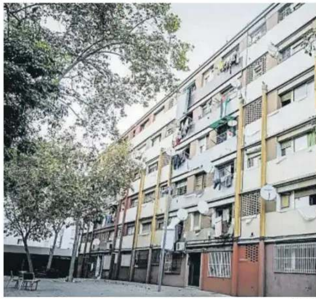
La calle Catania, en el Besòs, donde hay pisos apuntalados
